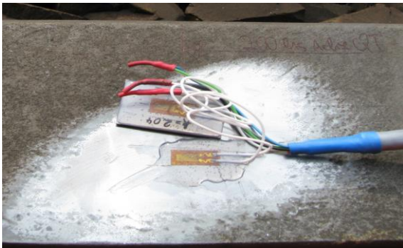
Bild 5: DMS mit 10 mm Messbasis und Temperaturkompensation an einer Stahlbrücke Foto: Nico Steffens
